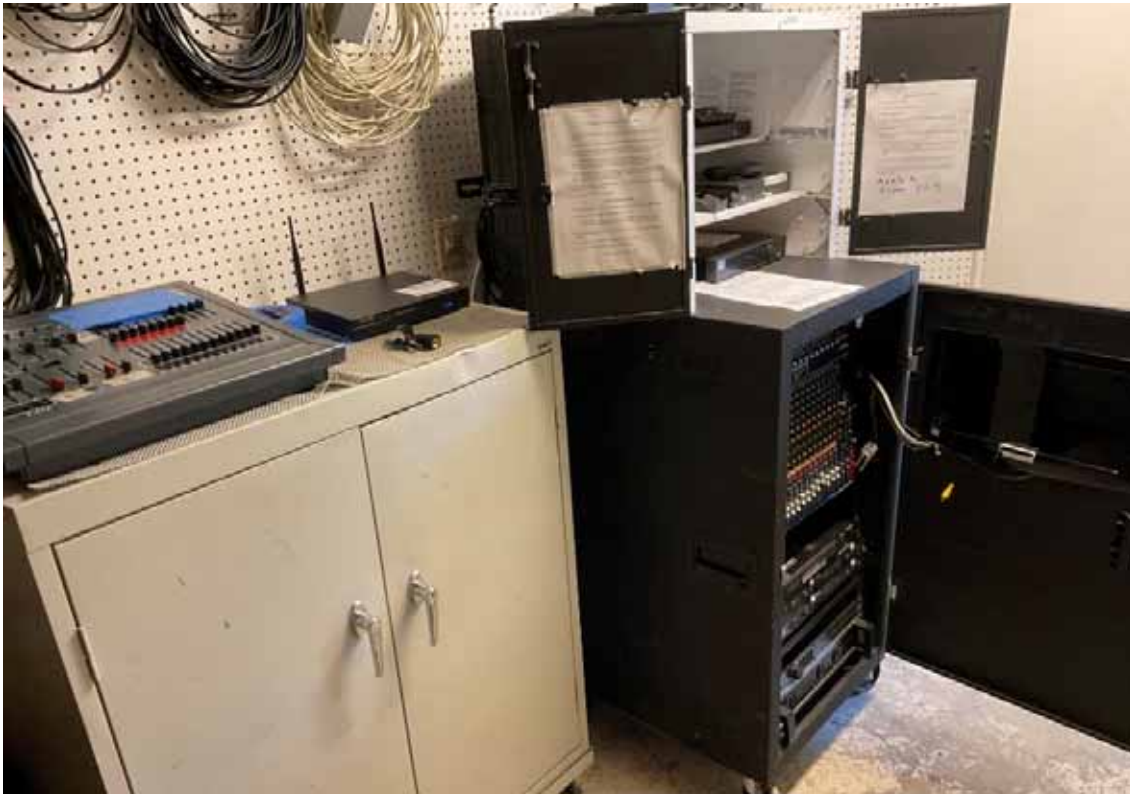
Pavilion Clubhouse AV Equipment
