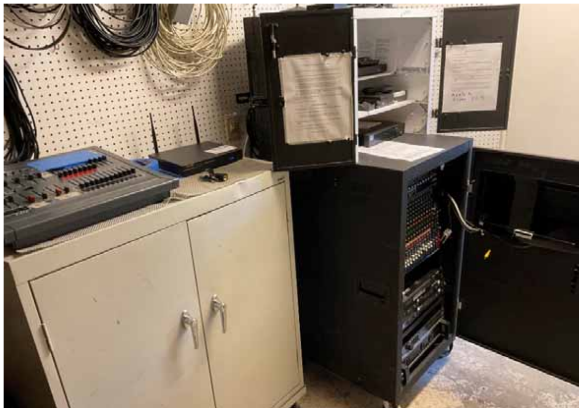
Pavilion Clubhouse AV Equipment
