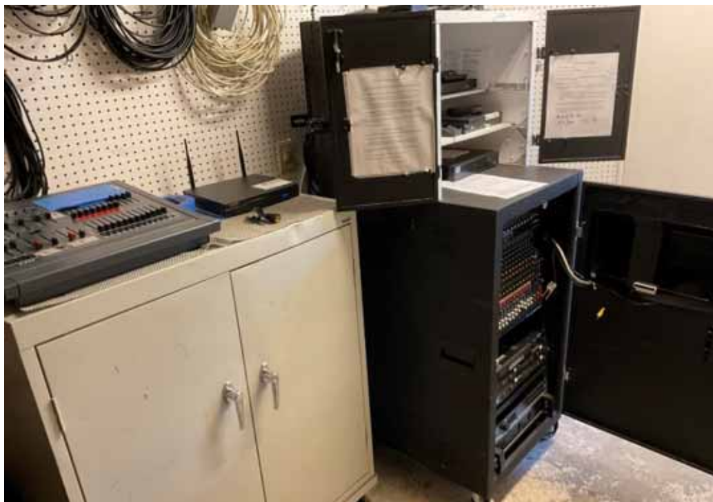
Pavilion Clubhouse AV Equipment
